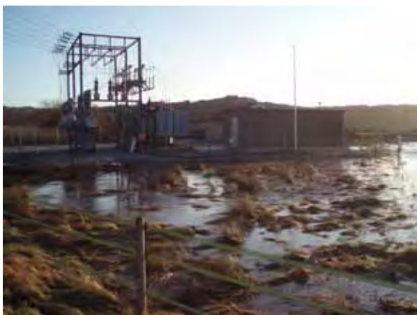
Området runt Morik elstation drabbas ofta av översvämningar.
